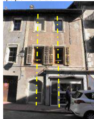
absence de recherche d'alignement et de symétrie, les différents niveaux ne sont pas différenciés : l'enduit est identique sur toute la hauteur
